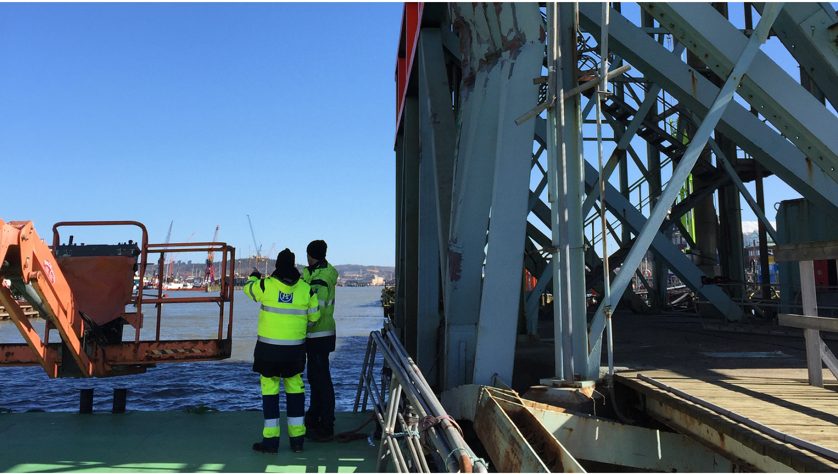
Bilden visar skadorna på metallbalkarna på delar av påseglingsskyddet under Götaälvbron. Bild: Trafikkontoret Göteborgs Stad.
